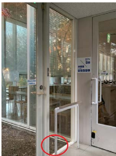
赤丸箇所にひび割れが生じた
